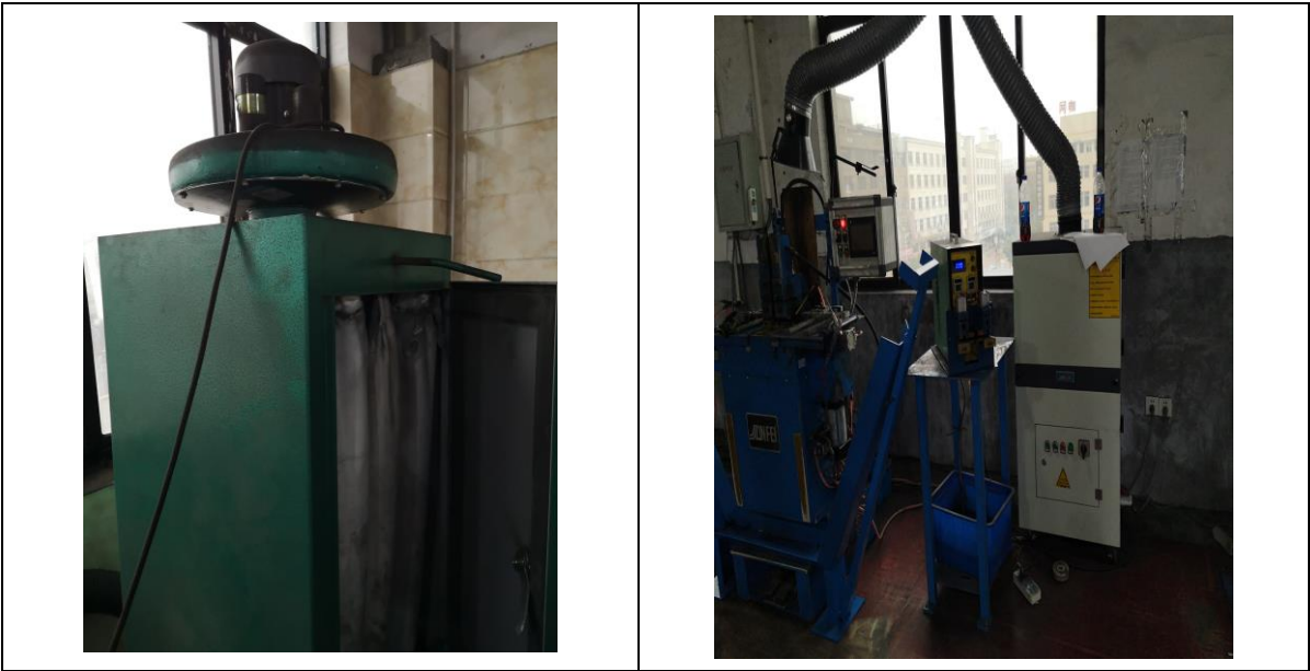
图 4.1-2 项目废气处理现场照片
