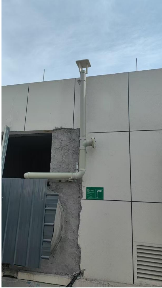
实验废气排气筒 DA002 及标识牌
