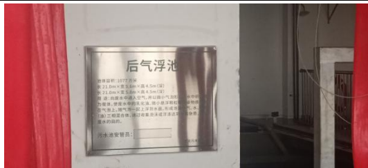
后气浮池标识牌
