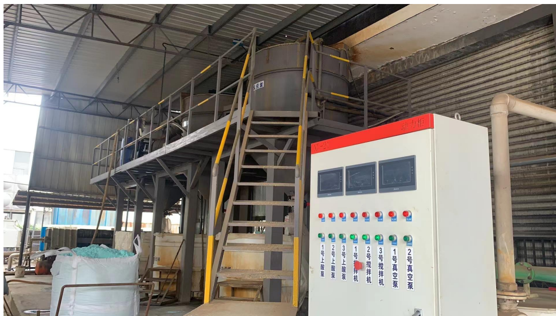
图 1 废水处理设施和酸回用
