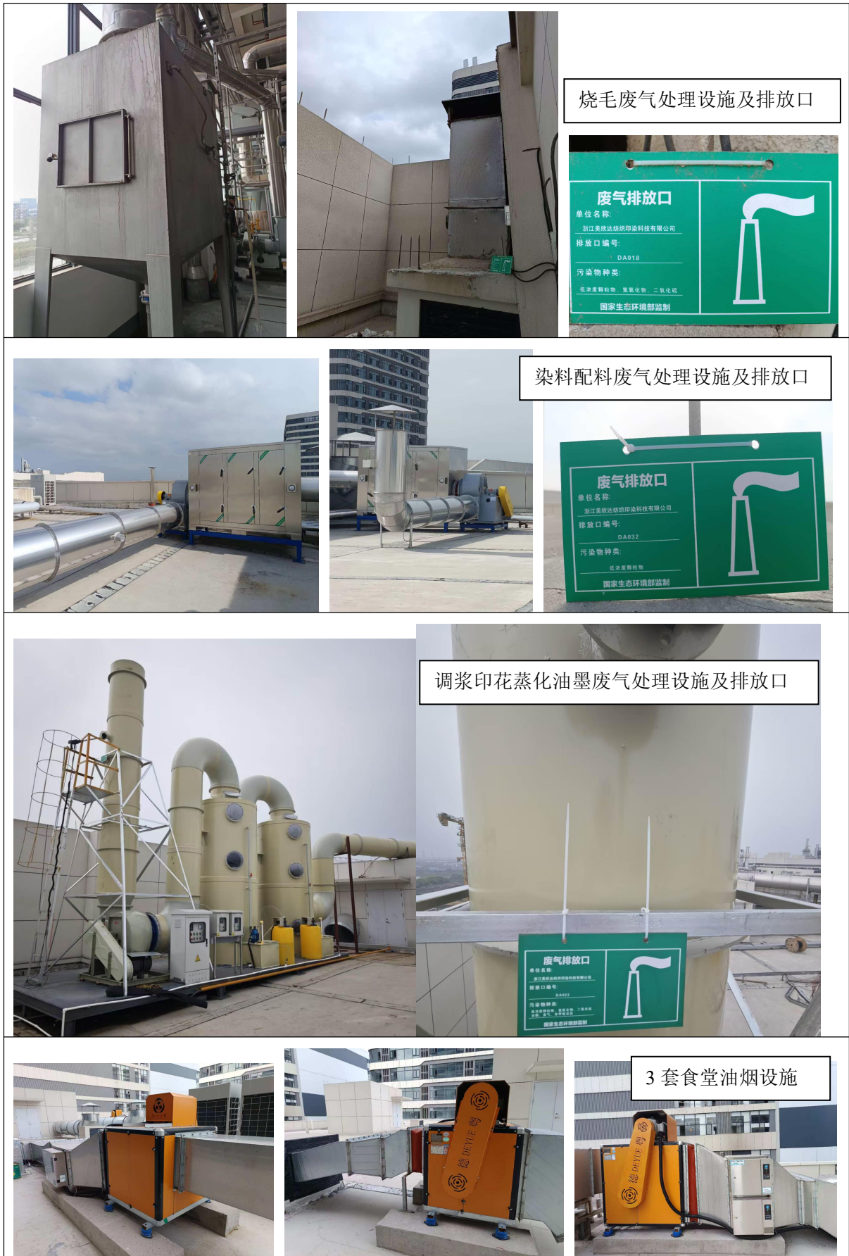
图 4-3 废气有组织处理设施现场
