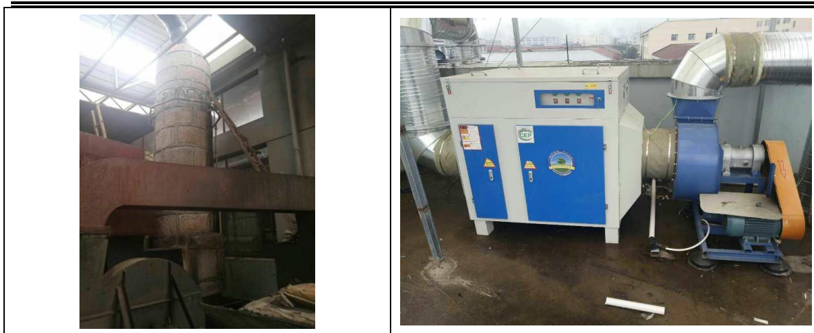
图 4.1-3 废气处理装置现场照片图
