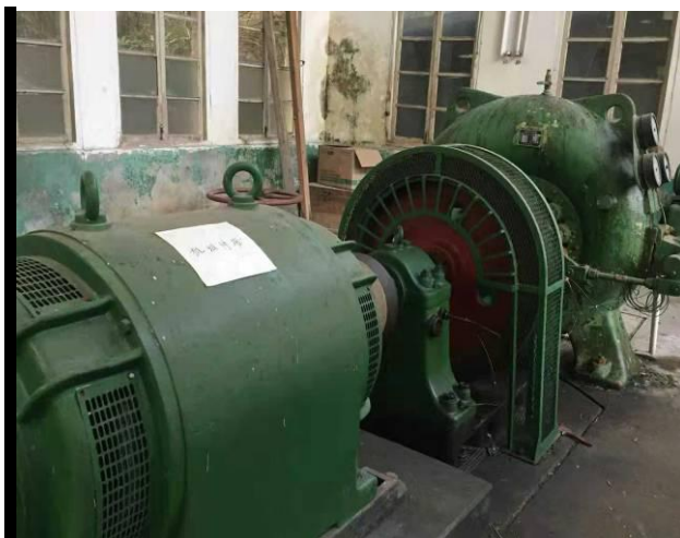
1×100kw 发电机组（已停用）
