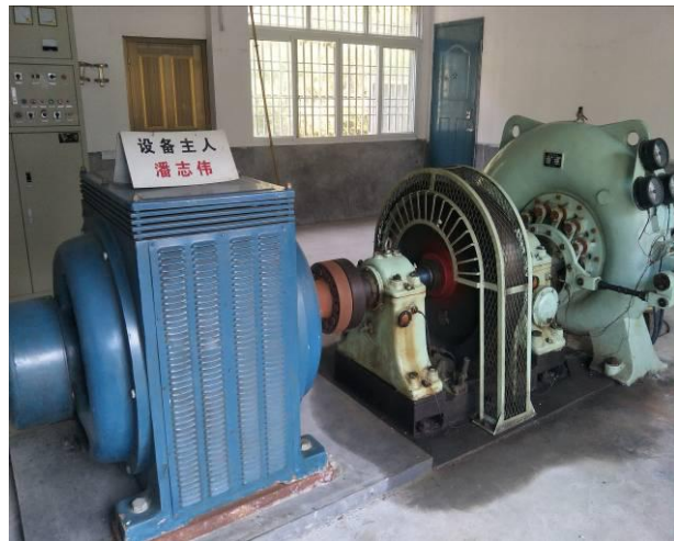
1×200kw 发电机组（在用）
