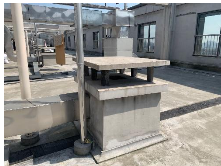
地下车库排气口
