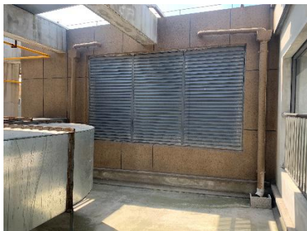
室外排气通风口
