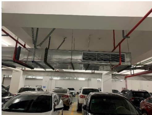
地下停车场通风管道
