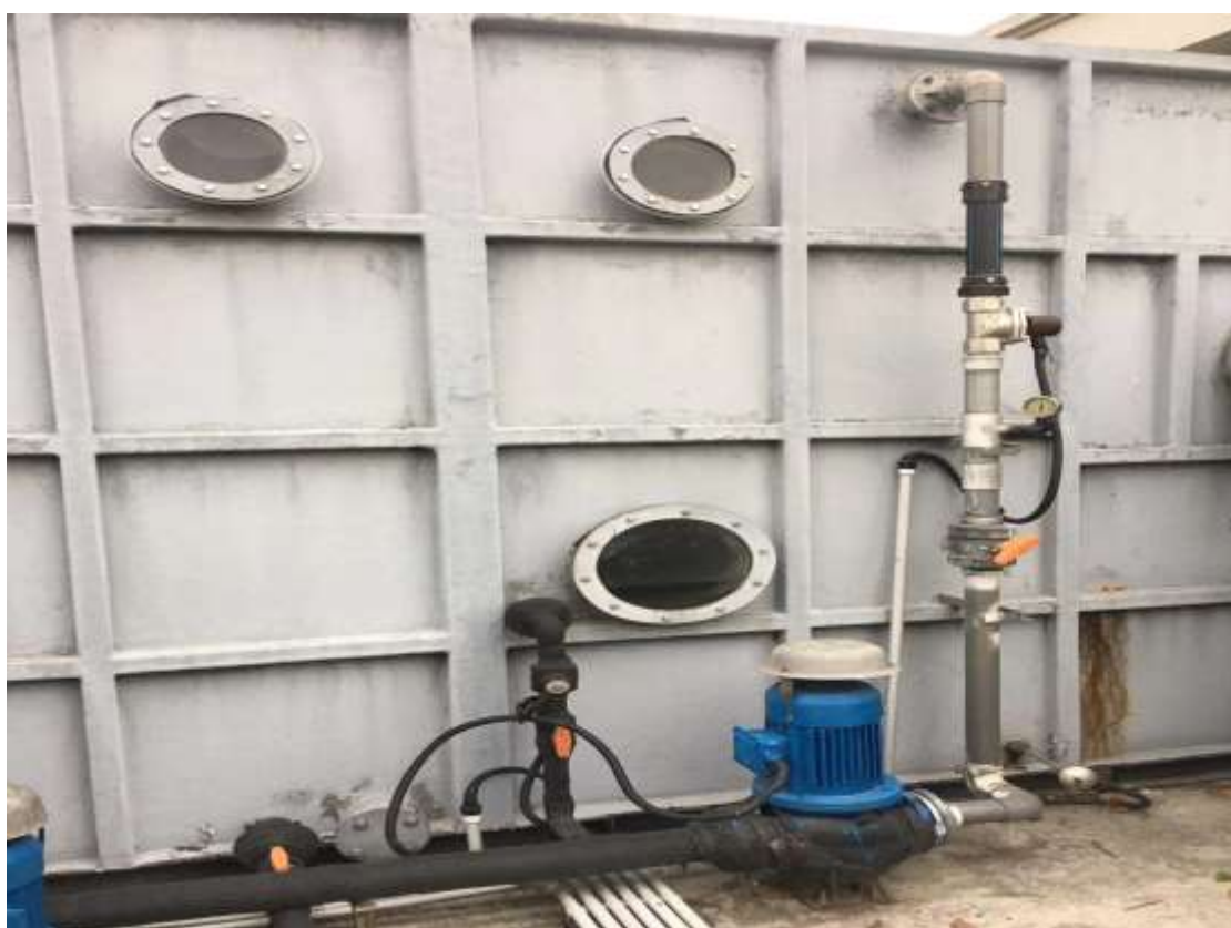
废气处理设施
